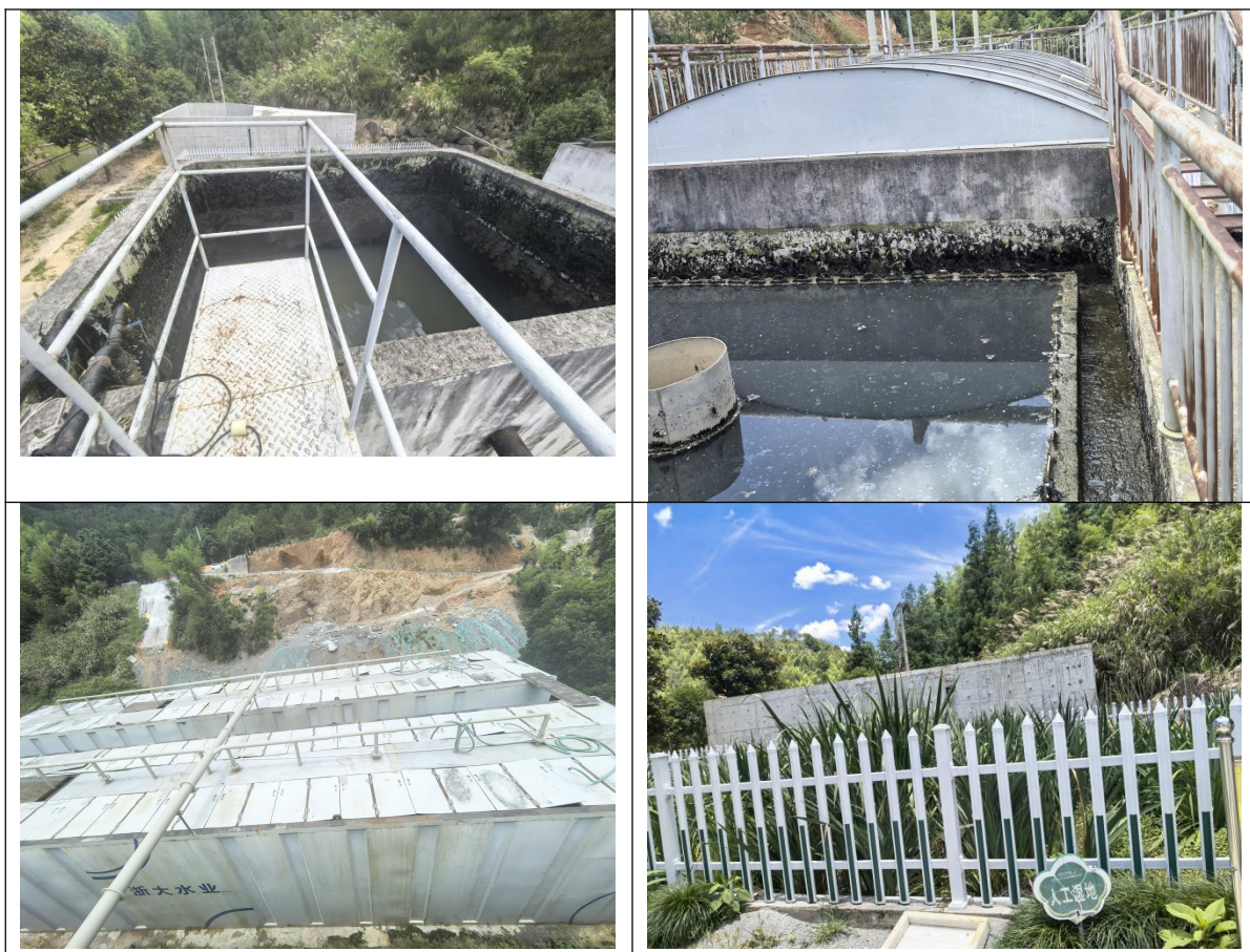
图 3.2-1 项目废水污染防治设施现场照片
